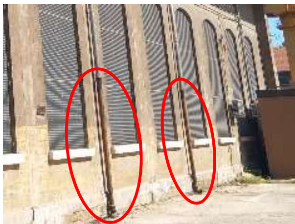
Figura 9 – Particolari dei tratti in ghisa dei discendenti in lamiera dell'edificio C13A
